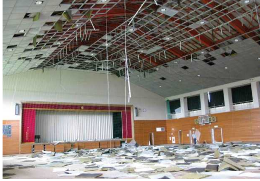
写真 1.3 : システム天井の地震被害 3)
