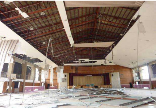
写真 1.5 : 在来工法による天井の地震被害 5)
