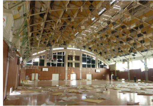
写真 1.2 : システム天井の地震被害 2)
