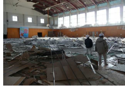
写真 1.4 : 在来工法による天井の地震被害 4)
