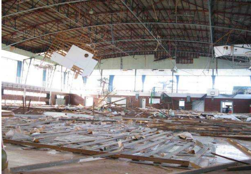
写真 1.6 : 木下地による天井の地震被害 6)
