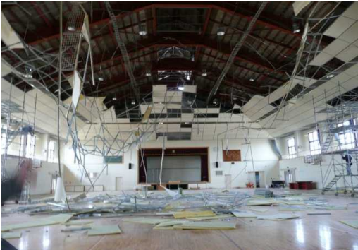
写真 1.1 : システム天井の地震被害 1)
